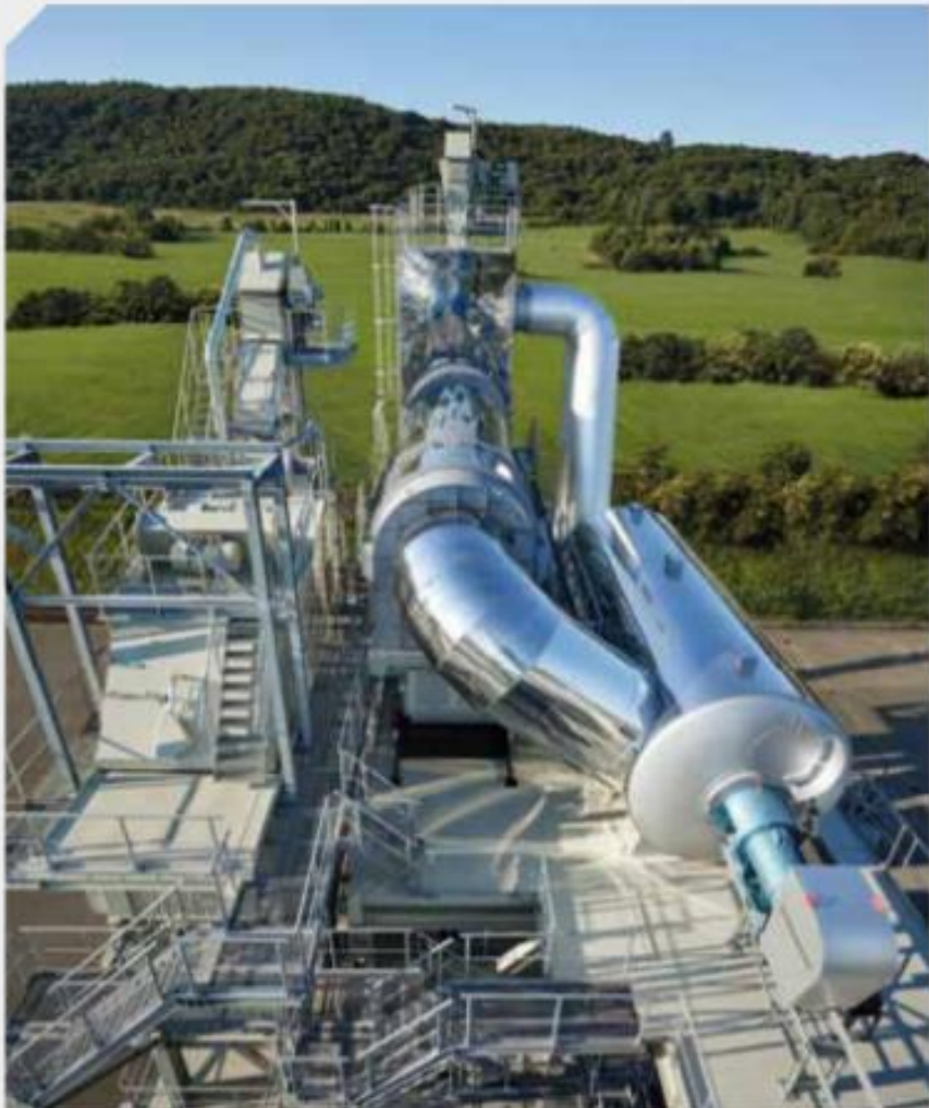
// HOT GAS GENERATOR
